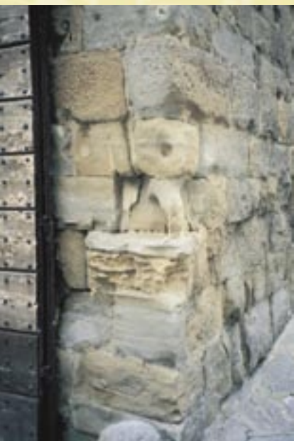
Particolare di pietra arenaria degradata dalle piogge acide e da agenti atmosferici in genere.
